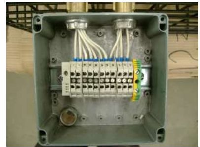
Conexionado de alta
